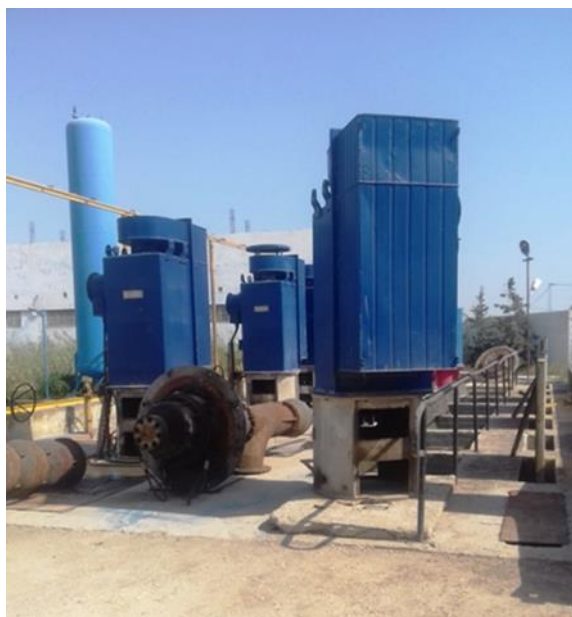
Figure 19 : Pompage vers Borj Touil
