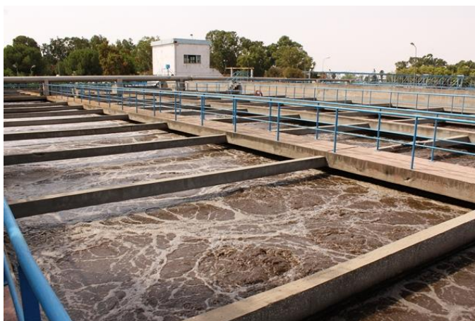
Figure 10 : Bassins d'aération de la STEP
