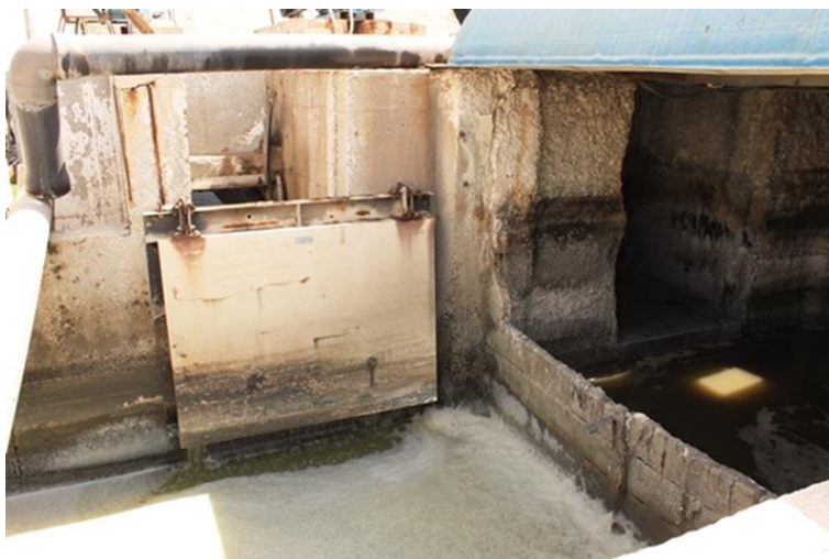
Figure 17 : Rejet de la STEP Côtière nord dans le canal de sortie
