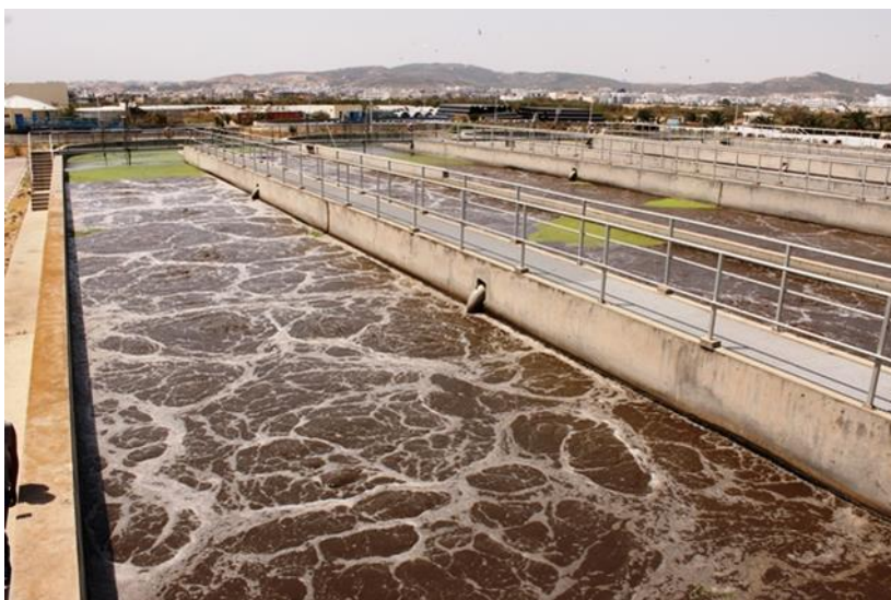
Figure 16 : Bassins d'aération de la STEP de Choutrana II
