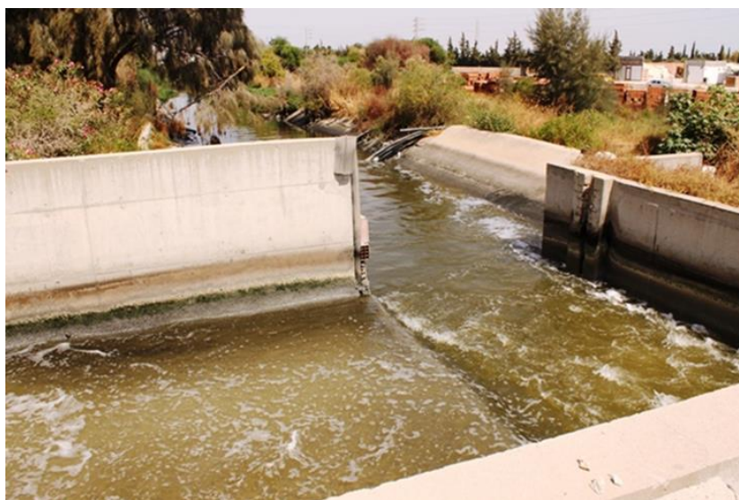
Figure 18 : Rejet de la STEP de Choutrana I dans le canal
