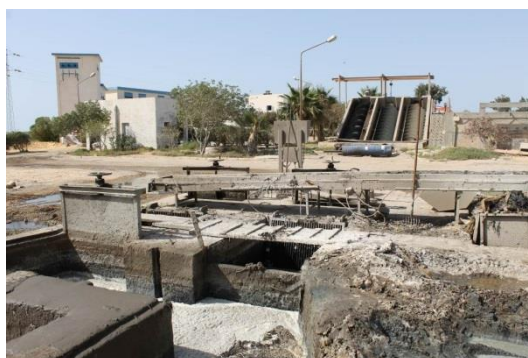
Figure 31 : poste de relevage principal (arrière-plan)
