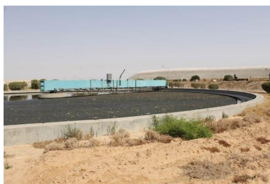
Figure 36 : bassin de décantation
