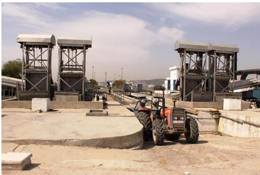
Figure 14 : Dégrilleurs à l'entrée de la STEP de Choutrana I
