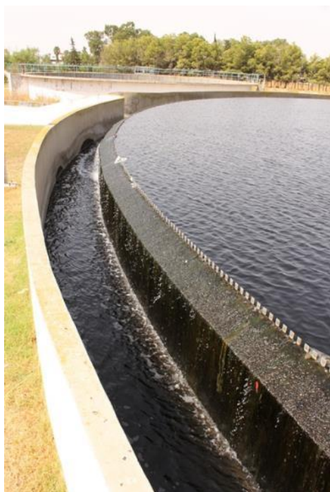
Figure 9 : Clarificateur de la STEP de Cherguia
