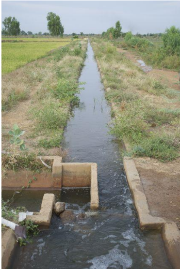
Figure 7 : canal 50 ha avec des fuites d'eau
