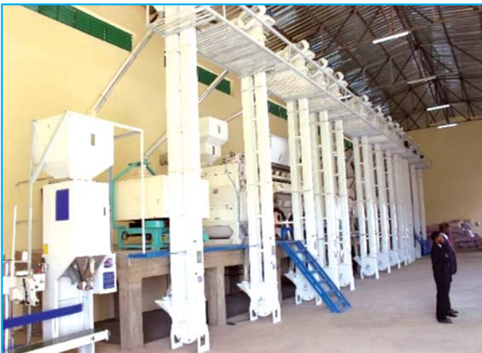
Unité Diocésaine Riz de Bagré (UDIRBA PLUS) : unité industrielle de transformation du riz (6 tonnes/heure)
