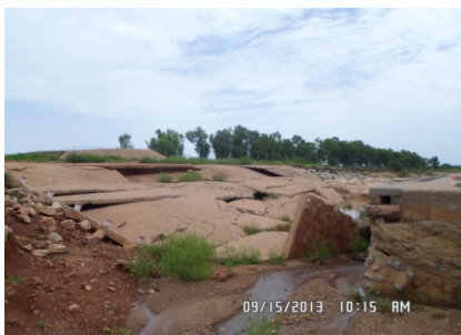
Dégradation des talus du Nakanbé et destruction du radier submersible au droit du chenal d'évacuation
