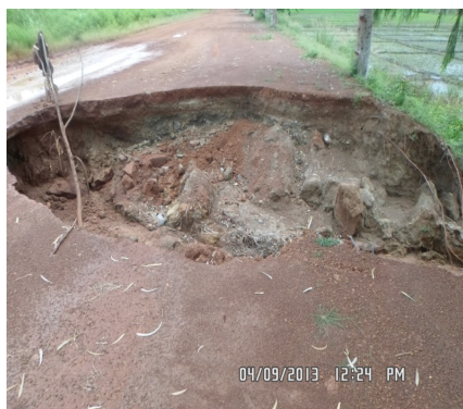
Grosse ravine sur la route de désenclavement
