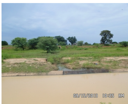
Débordement du canal primaire/dégradation cavalier
