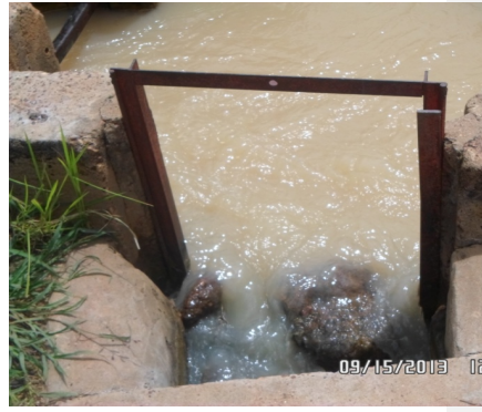
Destruction des vannettes des prises tertiaires
