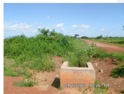
Menaces de destruction de canaux secondaires par les arbustes et les termitières
