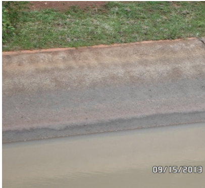
Baisse de niveau importante du niveau d'eau sur le bief C par dysfonctionnement des vannes avio et avis
