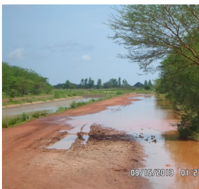
Absence de drainage et dégradations de la piste principale des 680 ha en rive gauche
