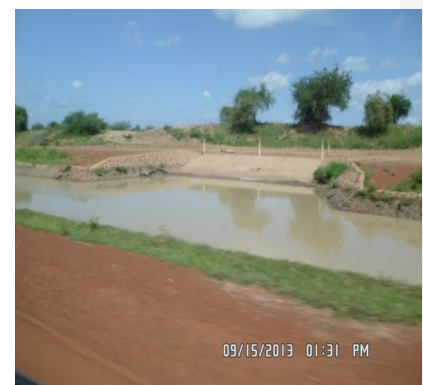
Dégradations des perrés maçonnés de protection des abreuvoirs
