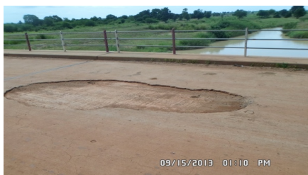
Craquellement et départ en lambeaux du béton de peau du tablier du pont sur le Nakanbé
