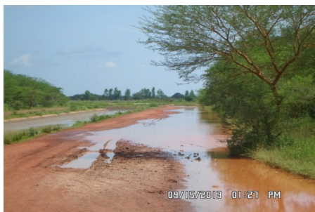
Plaques d'eau sur la piste principale du canal primaire des 680 ha (bief B)
