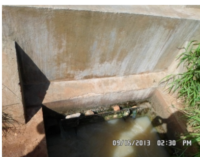
Blocage régulation vanne avio départ secondaire par des cailloux
