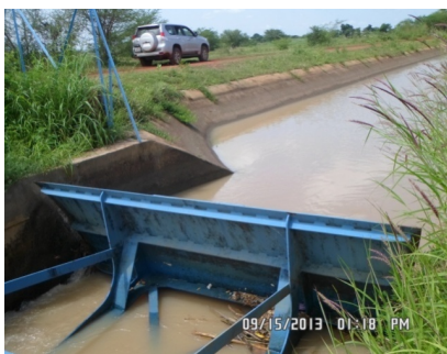
Absence de régulation aval vannes Avis bief C
