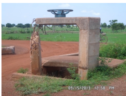
Destruction de vanne principale sur canal primaire alimentant les villages V8, V9 et V10
