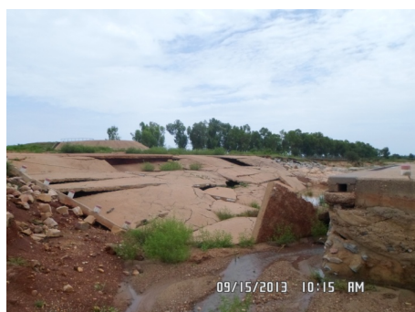
Destruction du radier dur le chenal d'évacuation
