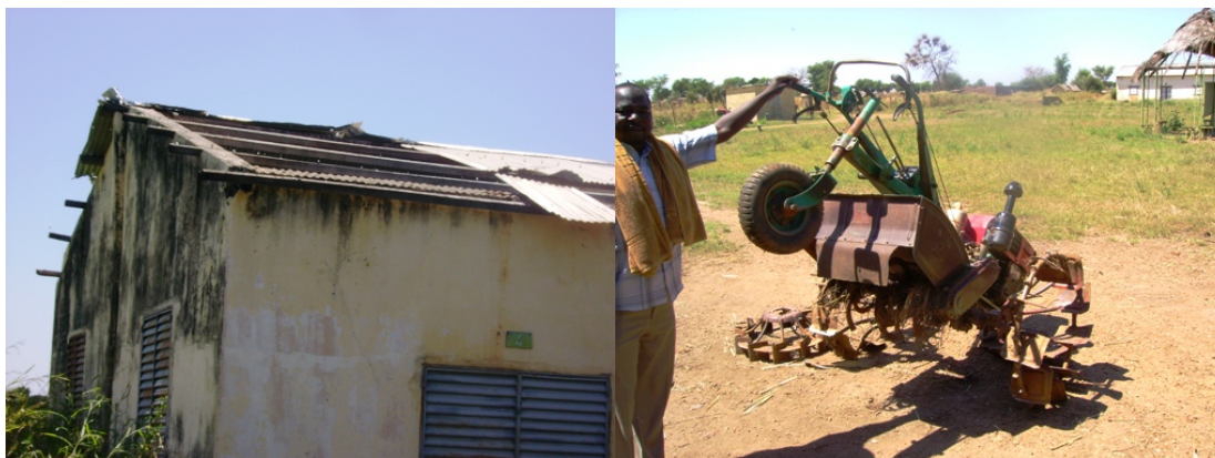
Une vue d'un bâtiment délabré et d'un motoculteur après environ un an de service (photos Jean NGAMINE)
