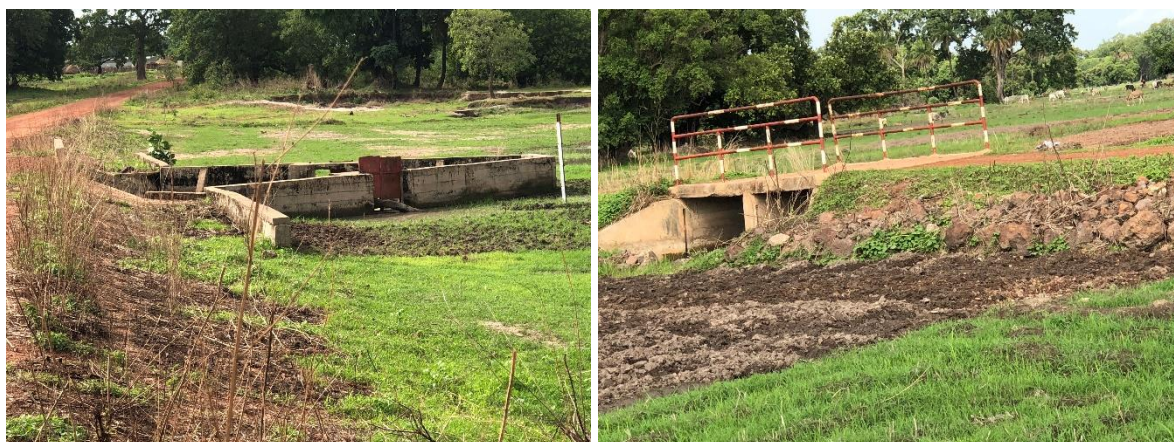
Photo 1 : Ouvrage dégradé – Vallée Saré Niyel
