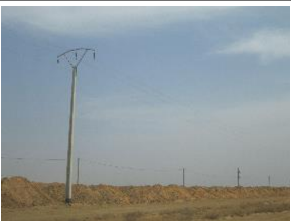
Photo 8 : Ligne électrique MT
