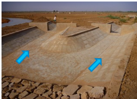
La distribution de l'eau peut se faire par les deux vannes.
