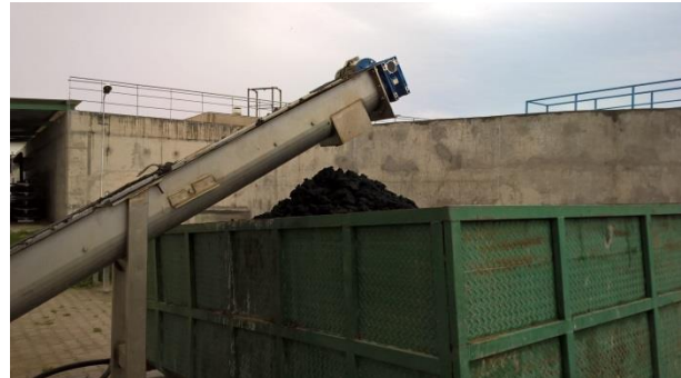
Chargement des boues en bennes après séchage
