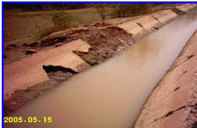
Photo 4 : Vue partielle du canal primaire du périmètre de Firgoun fortement dégradé
