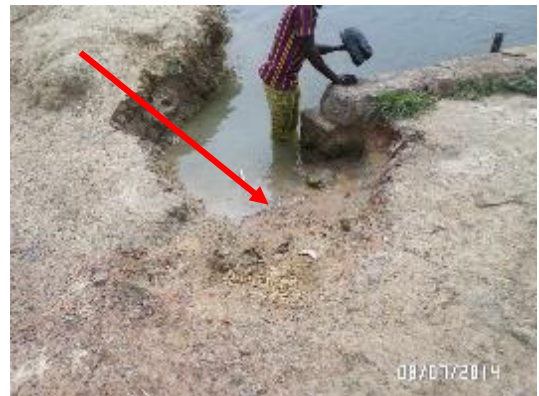
Figure 26 : Image montrant un début d'érosion au niveau du partiteur KLO ; Source : KOUAKOU et KOUMARE, visite de terrain 2014
