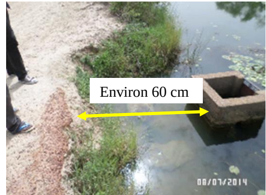
Figure 25 : Image de la vanne au niveau du partiteur KLO ; Source : KOUAKOU et KOUMARE, visite de terrain 2014
