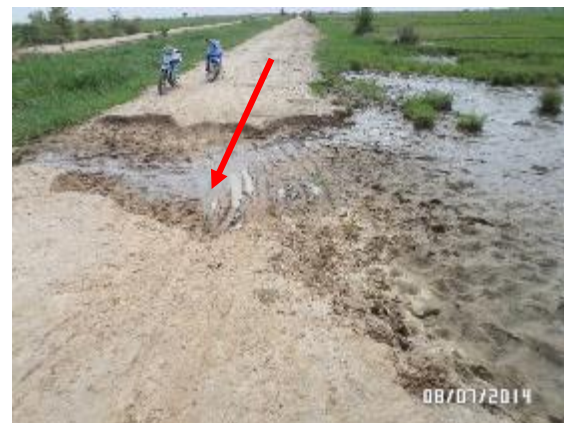
Figure 24 : Image de la route d'accès au niveau des drains KLO et Sébougou ; Source : KOUAKOU et KOUMARE, visite de terrain 2014
