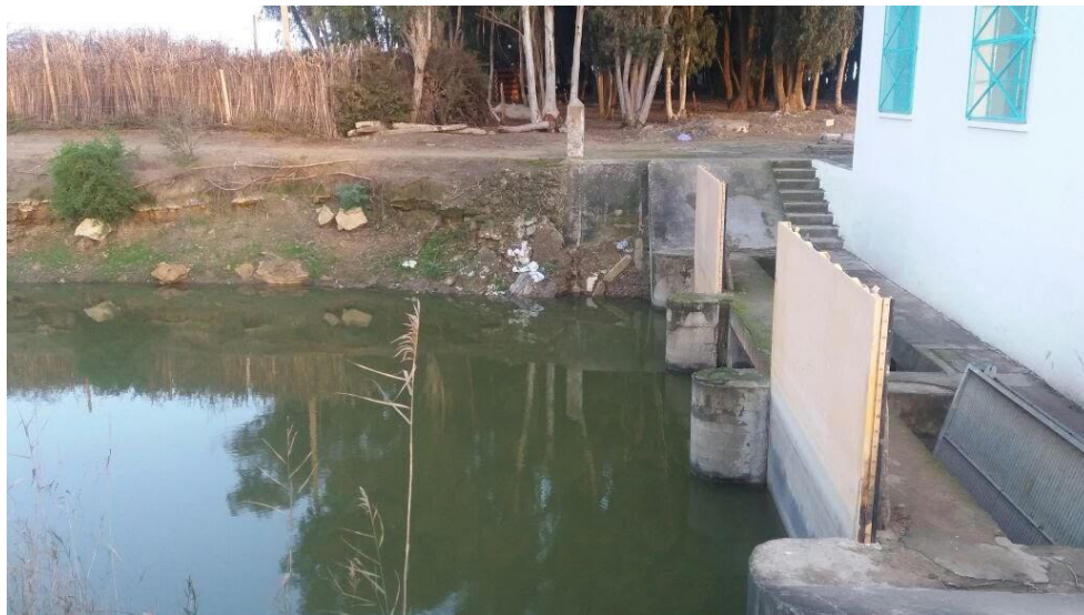
Photo n°7: Vannes murales de la station Qabat
