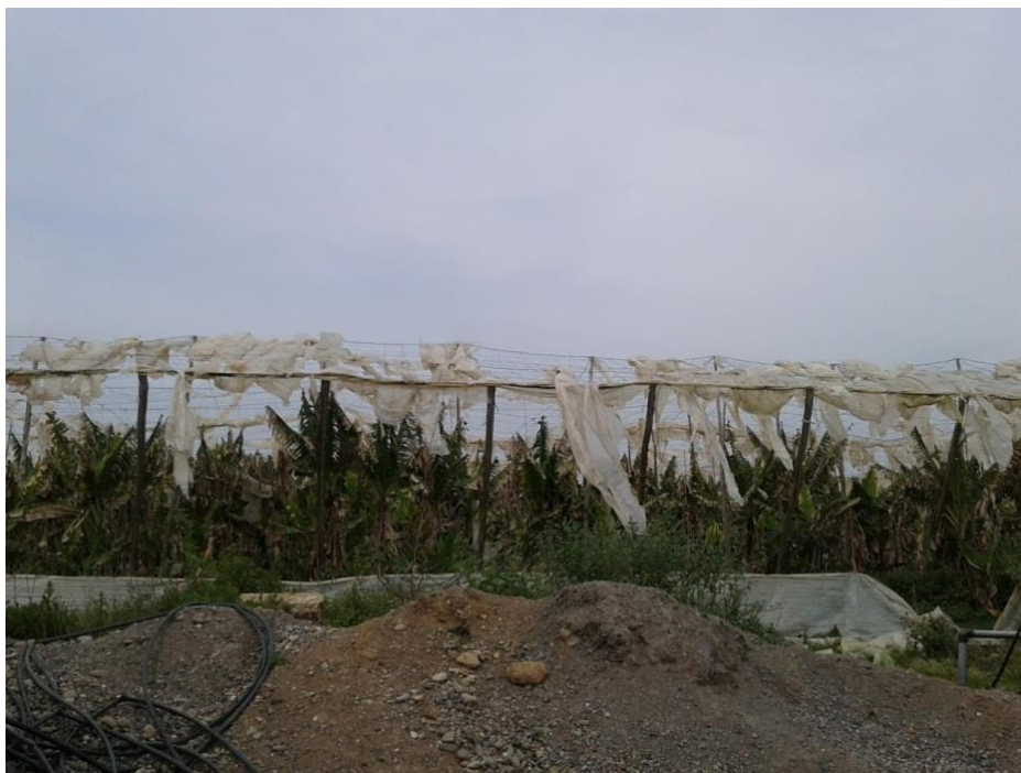
Photo n°9: Dégâts causés par les vents violents sur les serres de bananier des exploitants du cordon dunaire et des dunes intérieures
