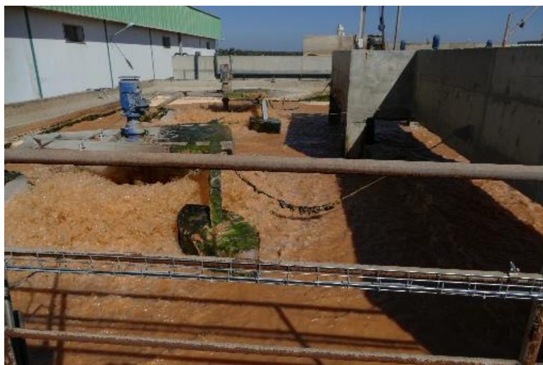
Figure 7 : Vue du bassin d'aération de la STEP de la Centrale laitière Vitalait
