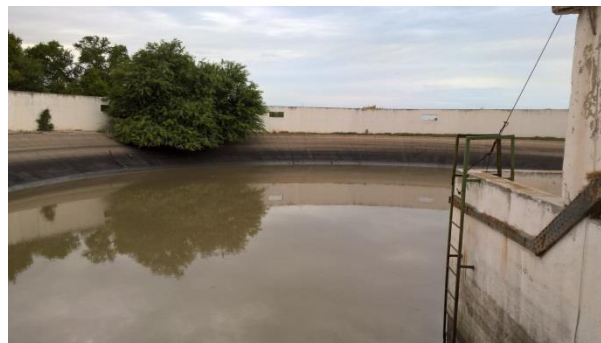
Bassin de stockage des eaux usées traitées
