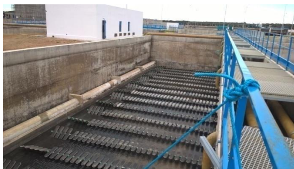
Sousse Hamdoun (nouvelle STEP) : bassin d'aération (2 ème file)
