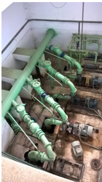
Station de pompage du réseau REUSE
