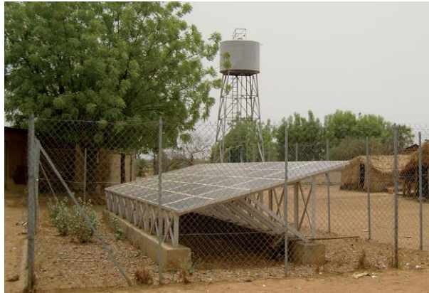
Figure 64 : Autre exemple de projet de pompage solaire en site isolé
