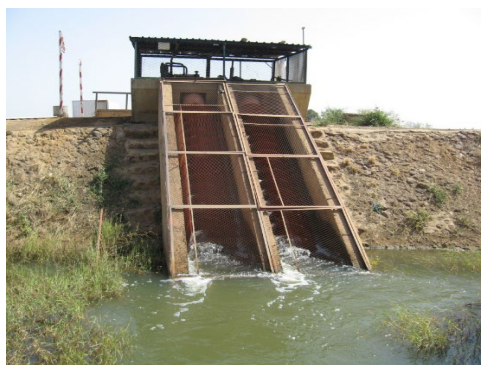
Figure 7 : station de pompage à Hydrovis
