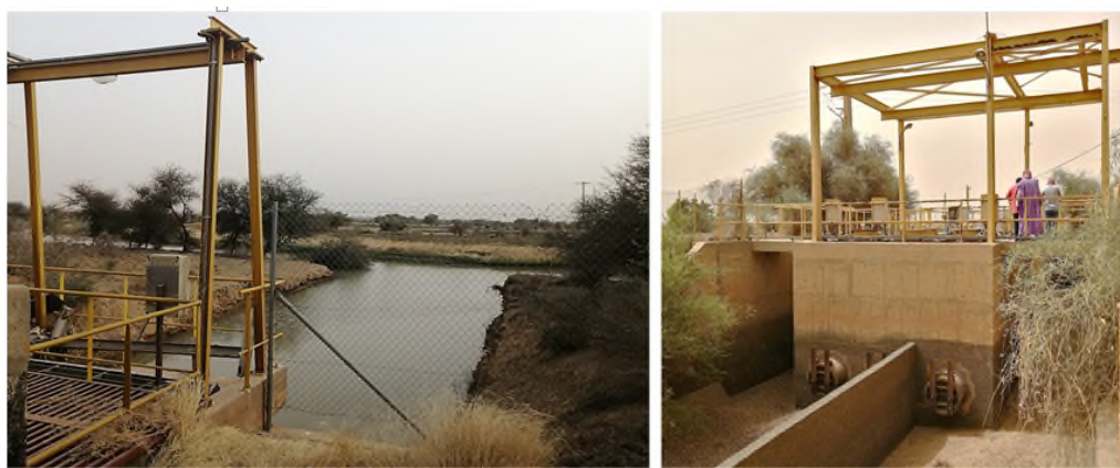
Photo 3: Prises d'eau des aménagements de MCA-Ngalenka (gauche) et Aéré Lao 2 (droite)
