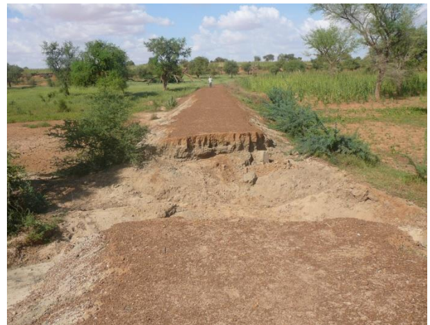
Photo 1: brèche sur une digue
