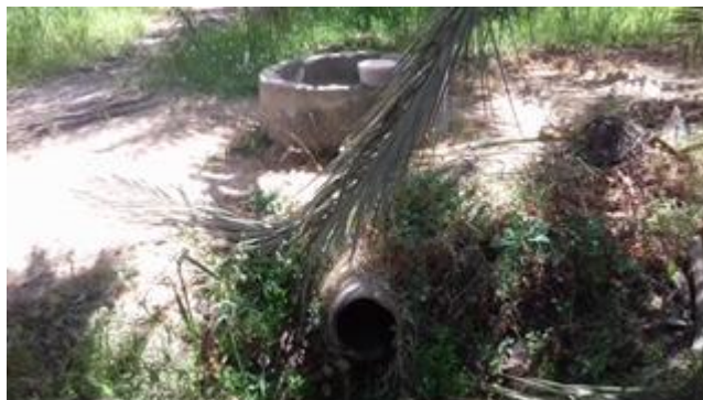
Photo 4: Un élément du réseau d'irrigation d'Hezoua 1
