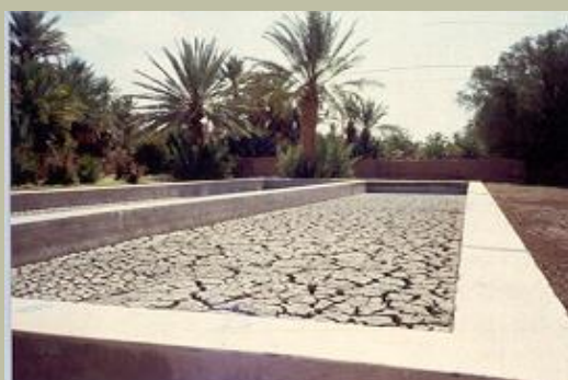
Figure 18. Lit de séchage des boues à Ouarzazate
