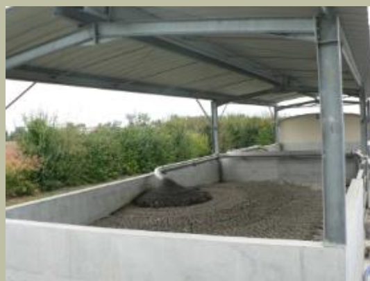
Figure 16. Aire de stockage des boues déshydratées 36
