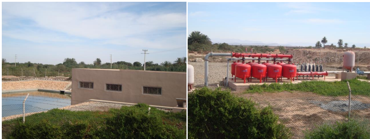
Figure 3 : Bassin d'accumulation et station de pompage et système de filtration
