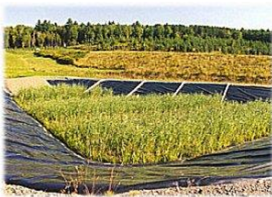
FIGURE 36: PHOTO LITS IMPERMEABILISES AVEC UN SYSTEME D'ARROSAGE ET DE DRAINAGE
