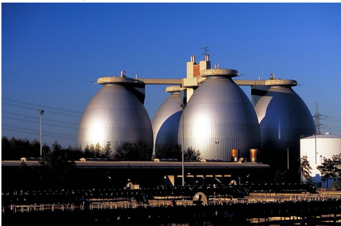
FIGURE 21 : DIGESTEURS (VOLUME 4 x 15 000 m 3 ) DE LA STEP BOTTROP DE L'EMSCHERGENOSSENSCHAFT
