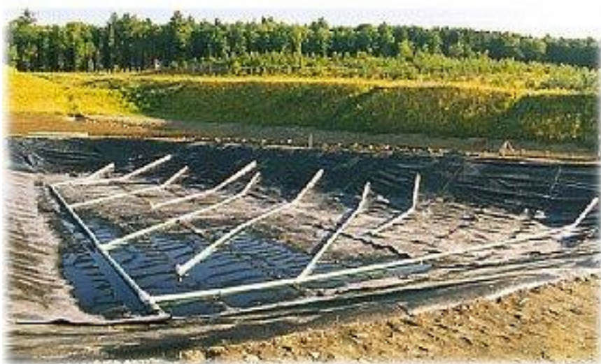
FIGURE 37: PHOTO LITS IMPERMEABILISES AVEC UN SYSTEME D'ARROSAGE ET DE DRAINAGE
