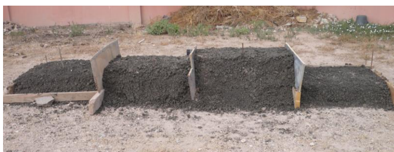
Figure 13 : 4 tas de boues de 30, 40, 50 et 20 cm de hauteur
