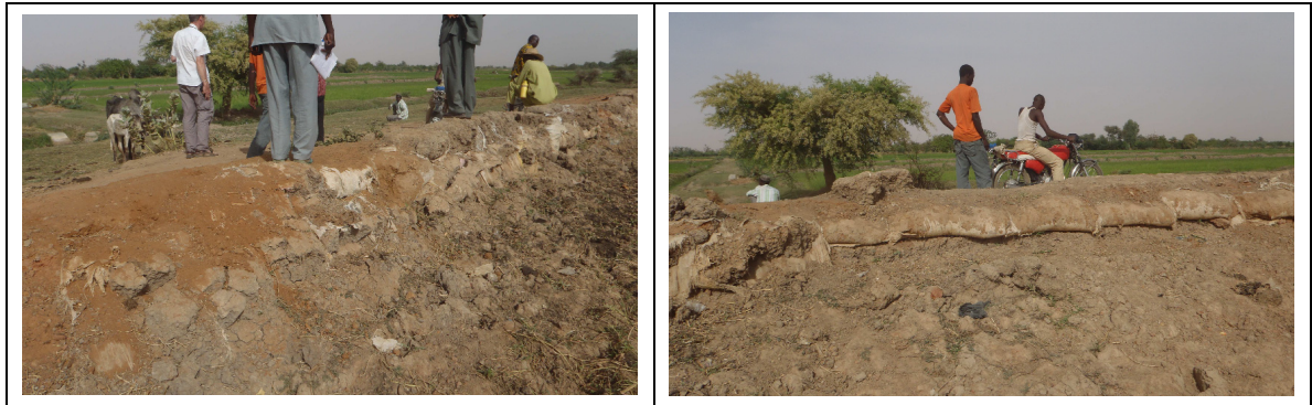
Photos 30 et 31 : Digues affaissées colmatées avec les moyens du bord (cas de Liboré)
