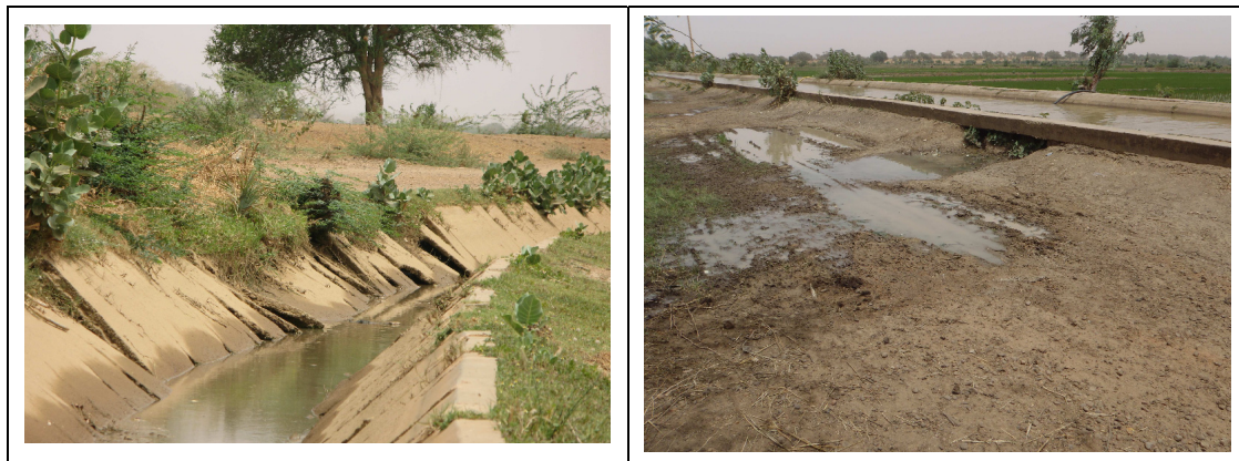
Photos 13 et 14 : Canaux principaux de Tiaguiriré amont et de Sébéry (Dalles affaissées à Tiaguiriré amont, cavaliers disparus et fuites à Sébéry)
