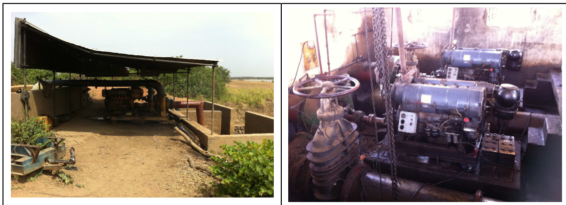
Photos 4 et 5 : Les stations de pompage alimentées en énergie thermique (cas spéciaux de la région de Dosso et de Tiaguiré Amont)
