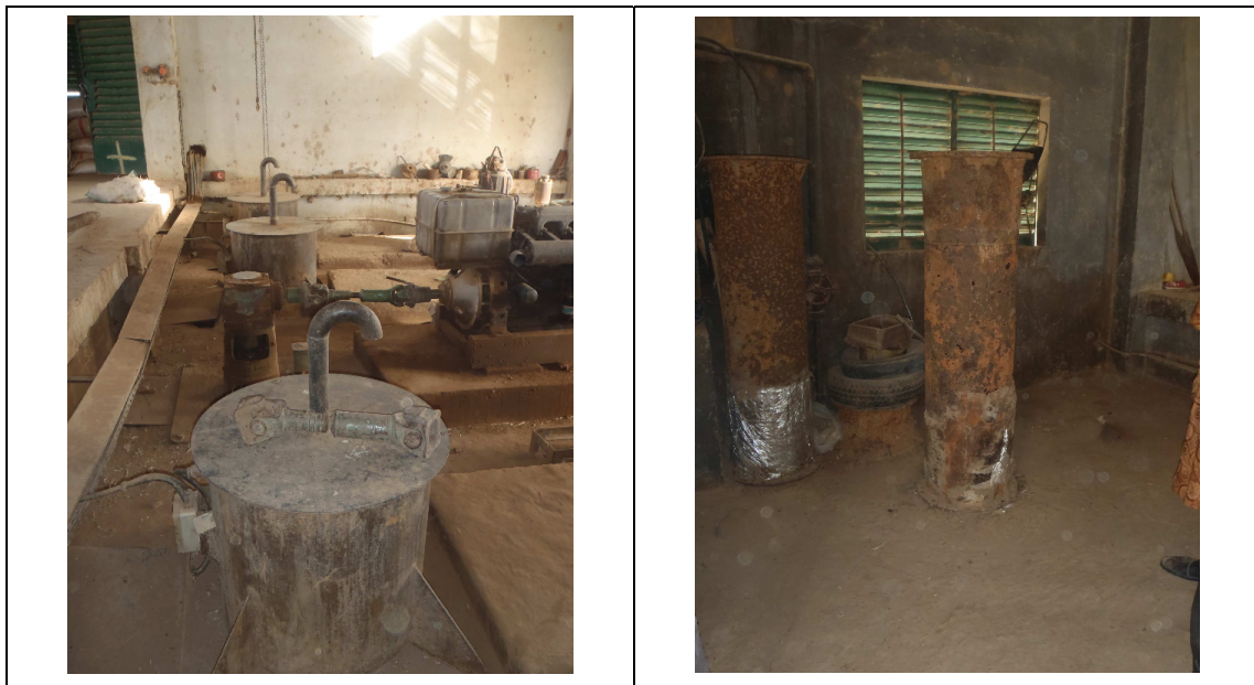
Photos 2 et 3 : Vue à l'intérieur de la station de pompage de Liboré. L'état des colonnes de refoulement cause des pertes énormes en eau
