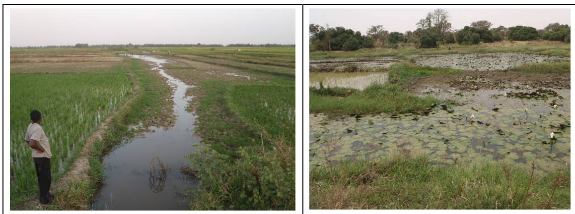
Photos 26 et 27 : Drains principaux envasés et bouchés (à Daïkaïna et à Tiaguiriré amont)
