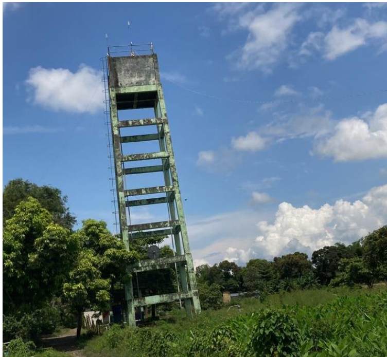
Photo 6. Le réservoir surélevé s'est rempli d'eau de puits pour alimenter les familles des communautés par le biais de tuyaux.
