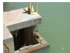
Déversoir de sécurité
