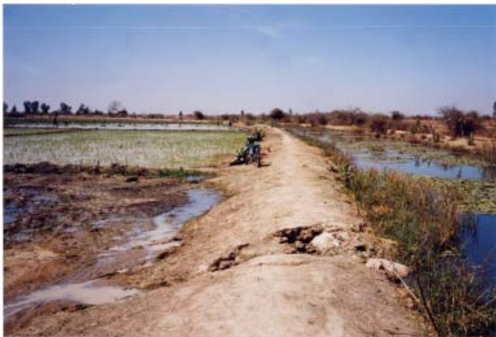
Photo 2 : mars 2002, secteur N'Débougou. Les digues sont fréquemment endommagées. Ici une brèche a été creusée puis partiellement colmatée de manière à amener l'eau dans une parcelle « hors casier ».
