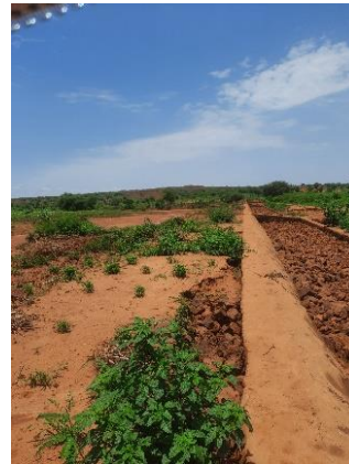
Affouillement en amont de la digue du Seuil SF5
