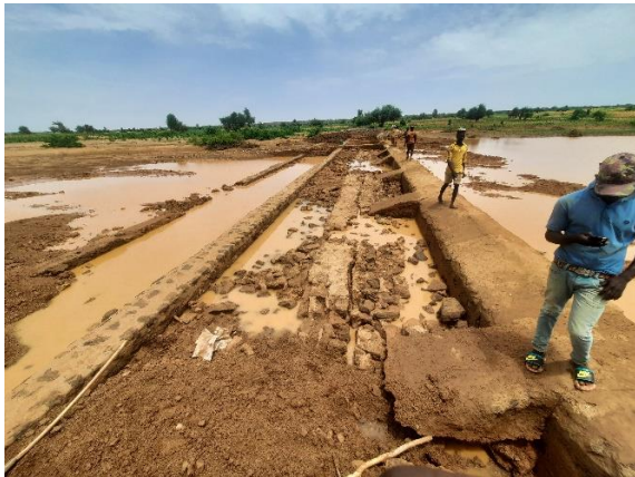
Affaissement et décrochage de la structure principale du seuil SF5
