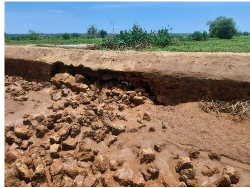
Effondrement d'une section de la digue du Seuil SF3
