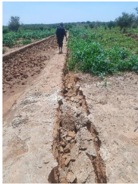
Affouillement en amont de la digue du Seuil SF3
