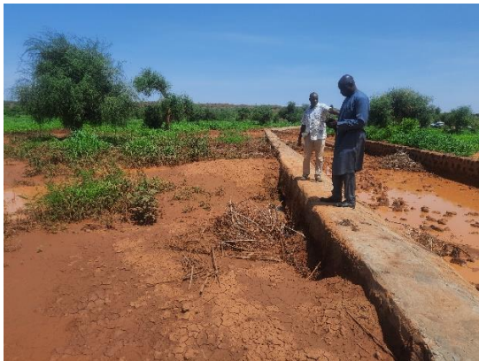
Affouillement en amont de la digue du Seuil SF4
