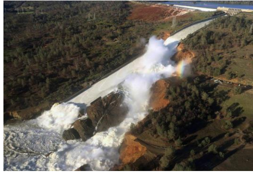
Figura 2.10: Inundación por falla de infraestructura hidráulica (Presa Oroville-California)
