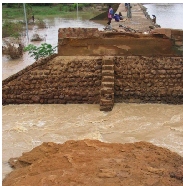
Figure 6 : Rupture de barrage dans la région de Koubri lors de la crue du 11 Juillet 2009. Crédit : N. Augis (IRD), In Cecchi, 2006.
